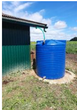
1 pav. Lietaus surinkimo nuo stogo sistema analizuojamame ūkyje. Fig. 1. Rainwater harvesting system from the roof in the analyzed farm
